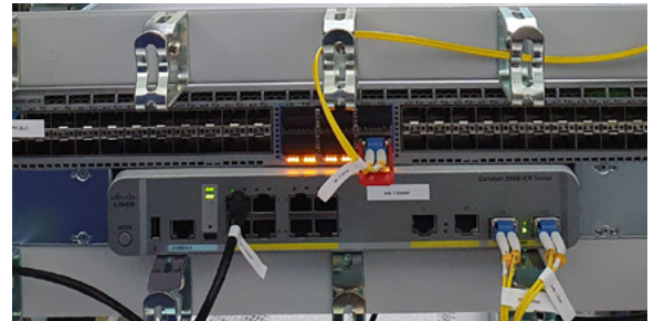
Rack Switch au POP de Bissen
